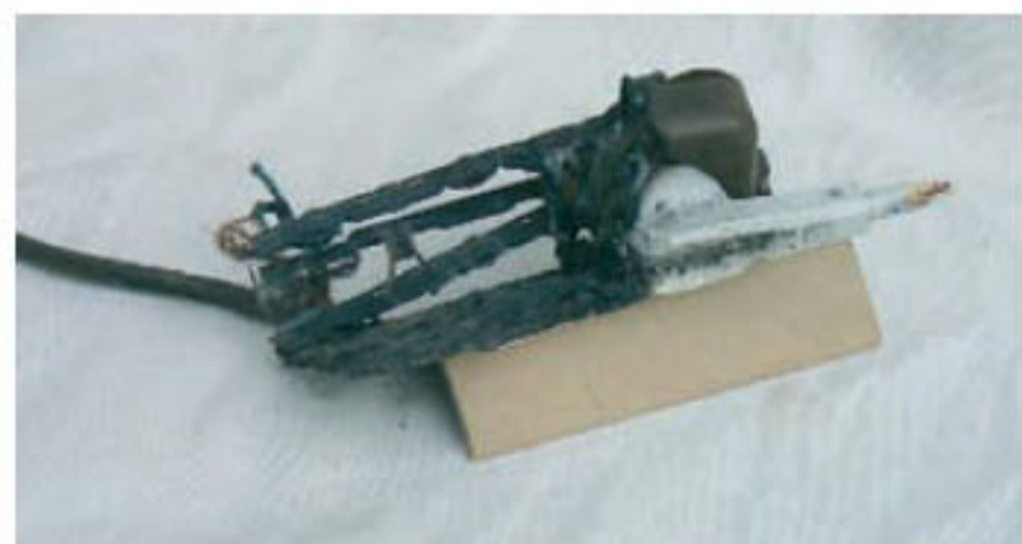
Diese überlastete Tischsteckdose verursachte einen Küchenbrand
